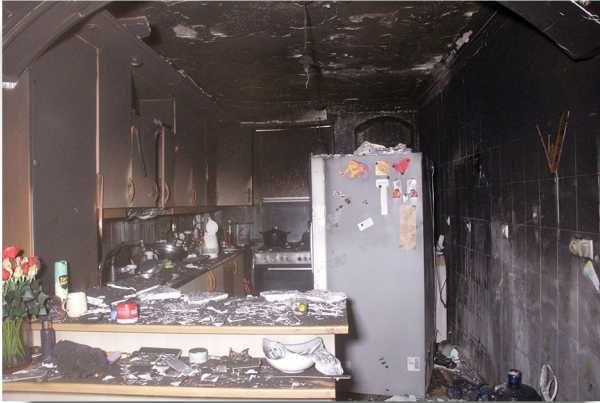
اطفاء حریق منزل ۱۴۰۱/۰۴/۰۵
