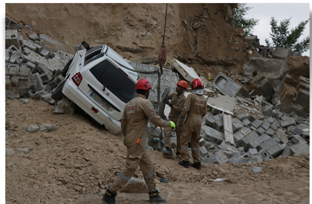
ریزش آوار در گودبرداری ۱۴۰۲/۰۷/۳۰
