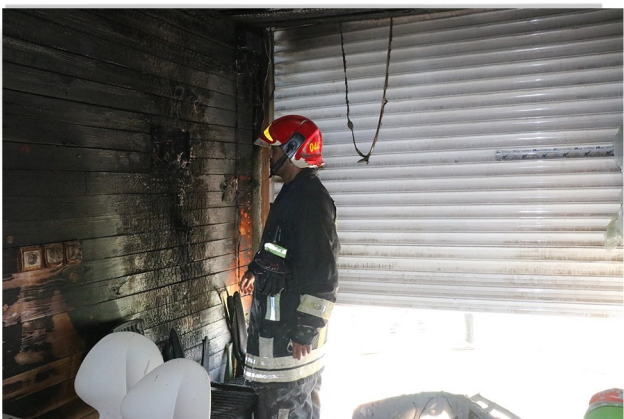
حریق فست فود ۱۴۰۲/۰۶/۱۷
