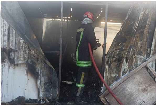
حریق کانکس تاسیسات ۱۴۰۳/۰۸/۱۰
