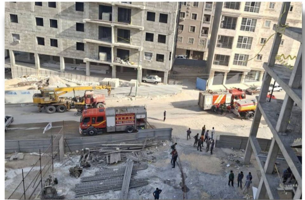
حریق ساختمان نیمه ساز ۱۴۰۴/۰۳/۲۱
